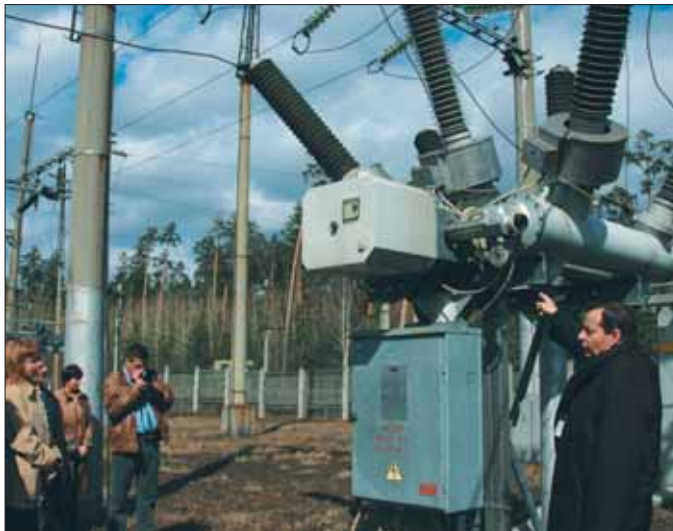
Ячейка PASS, действующая на подстанции «Родник» в Екатеринбурге
