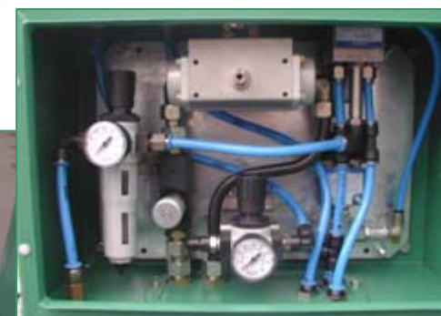
Блок управления пневматикой
